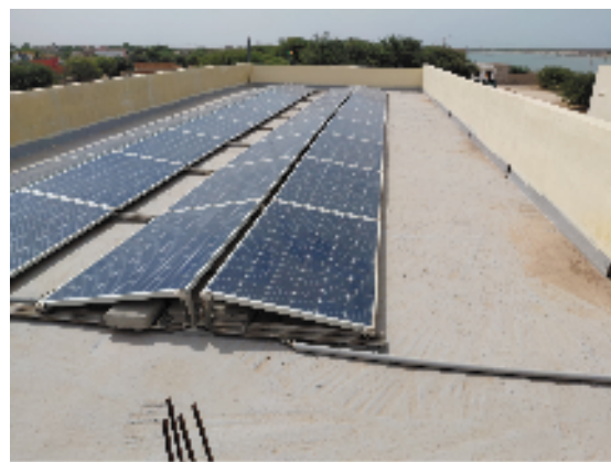
Mit finanzieller Unterstützung deutscher Natur-Freundegruppen installierte Solaranlage auf dem Dach des Naturfreundehauses in PetitMbao © Norbert Holtz
